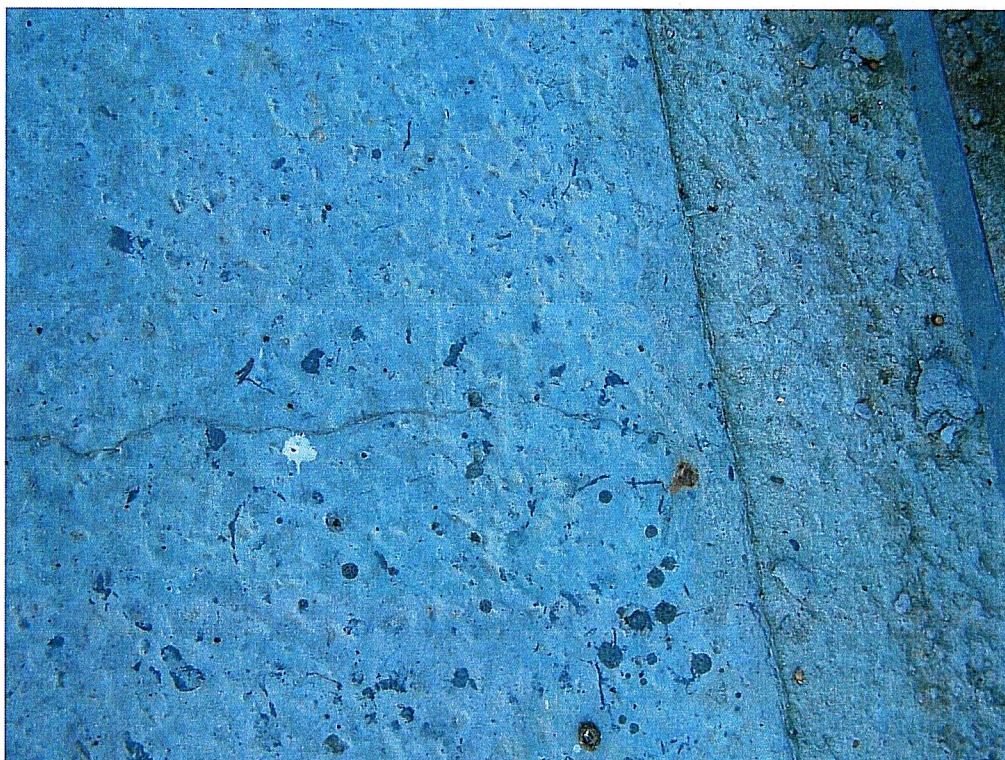
Foto.11 Widoczne zarysowania po wyschnięciu wody
