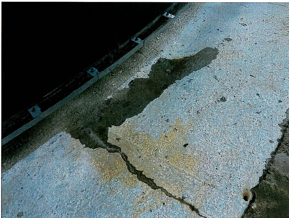
Foto.10 Wycieki w miejscach styku starego i nowego fundamentu, przez rowek kotwiący oraz rysy w fundamencie
