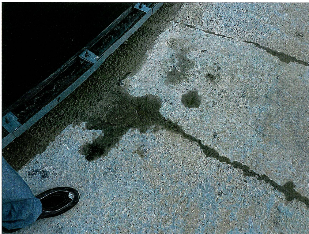
Foto.8 Wycieki przez rowek kotwiący oraz rysy na przerwie dylatacyjnej
