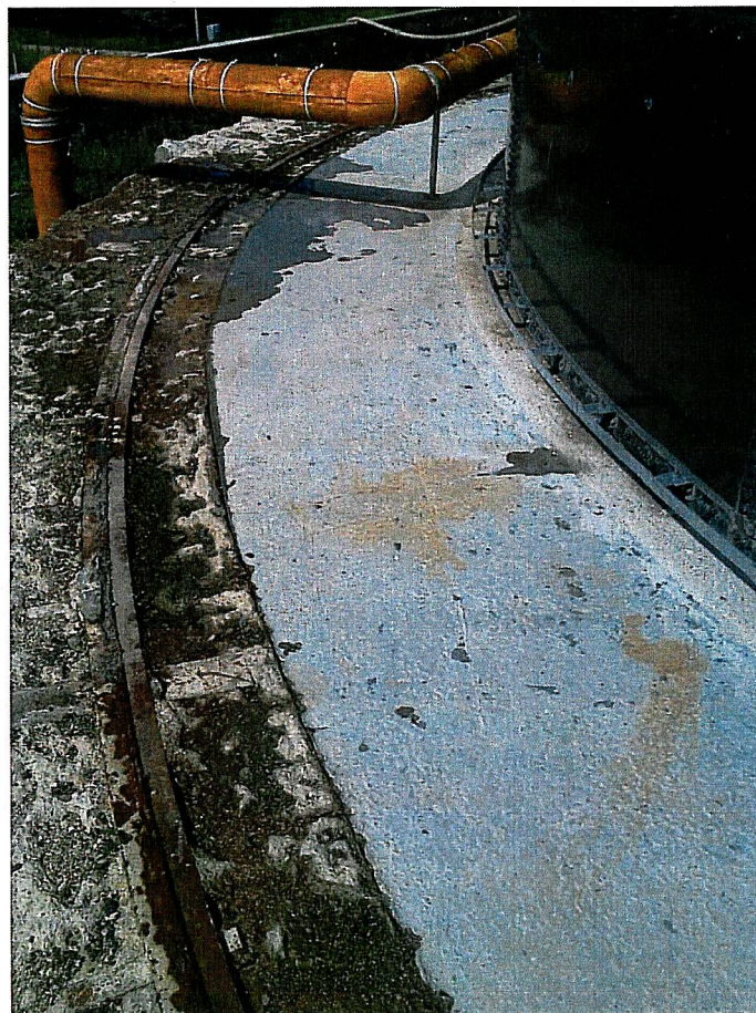
Foto.7 Wycieki w miejscach styku starego i nowego fundamentu oraz rysy
