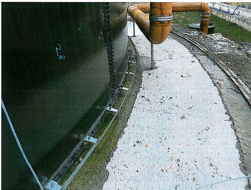
Foto.9 Wycieki w miejscach styku starego i nowego fundamentu, przez rowek kotwiący,
