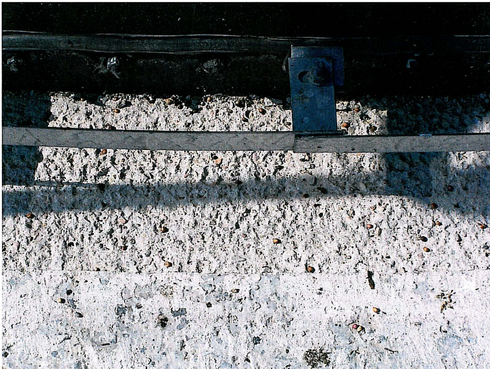
Foto.2 Widok zalanego rowka kotwiącego (str. zewnętrzna)
