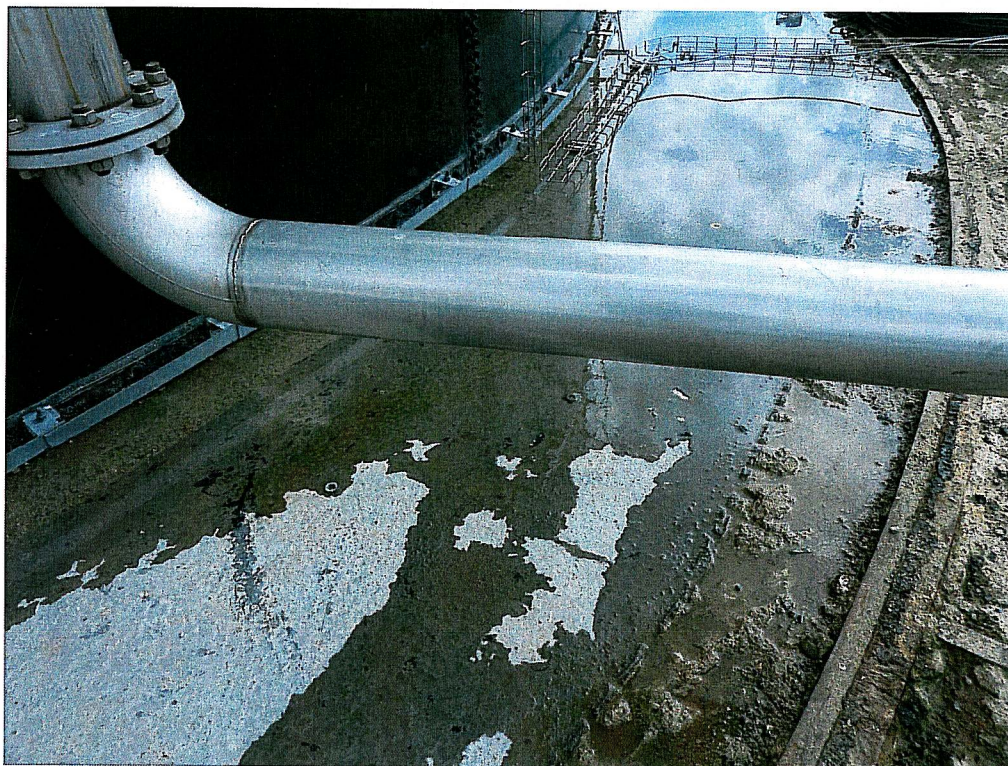
Foto.4 Wycieki wody przez fundament
